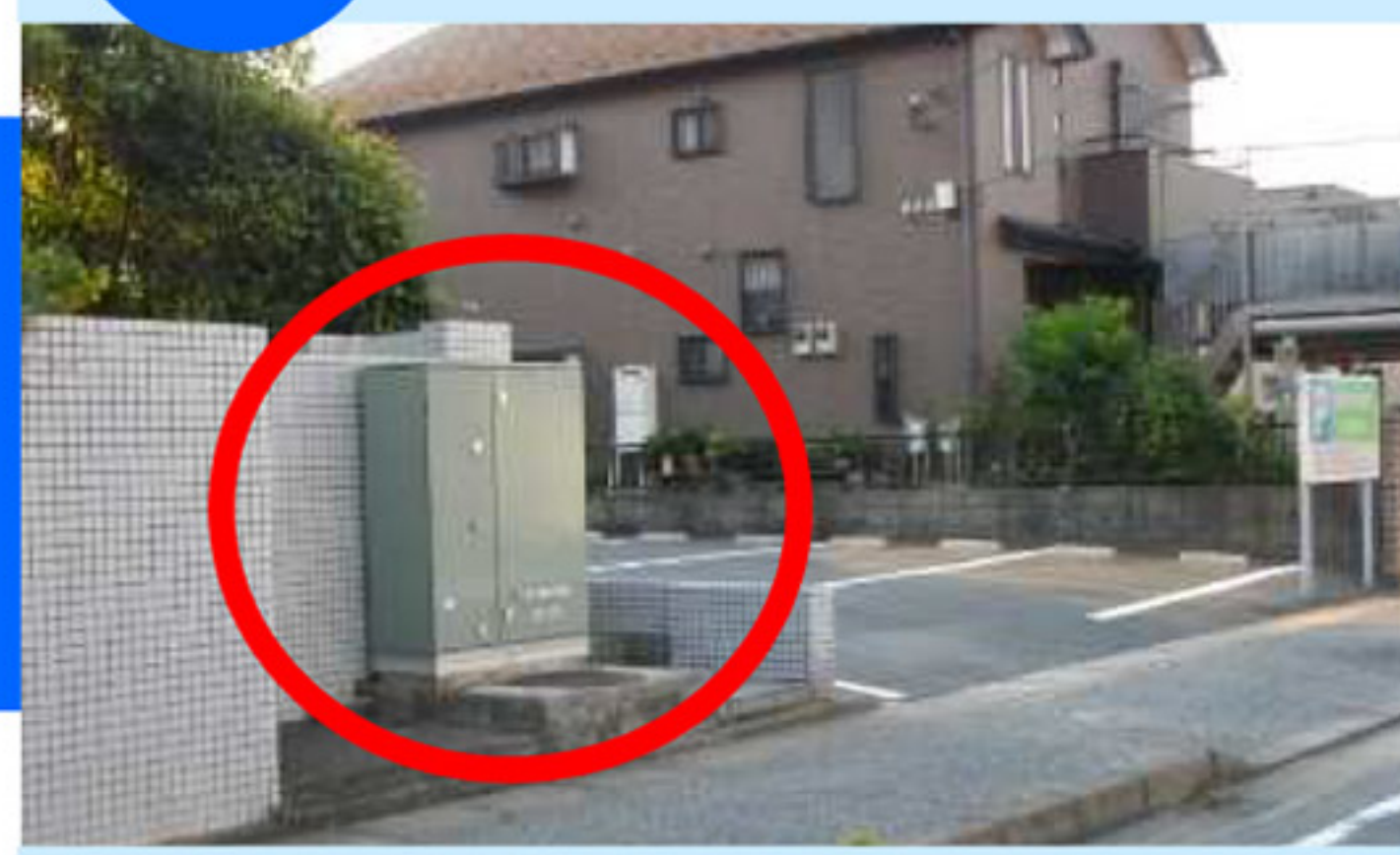
トヨー柏ハイム横変電設備周辺
