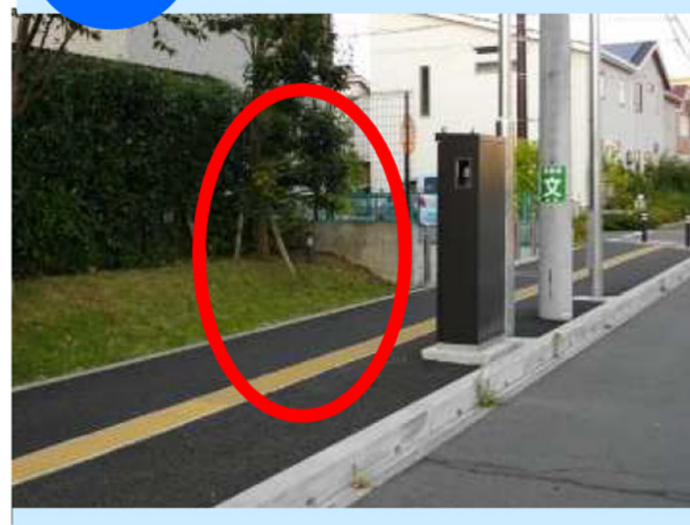
東武バス停先20m 変電設備周辺
